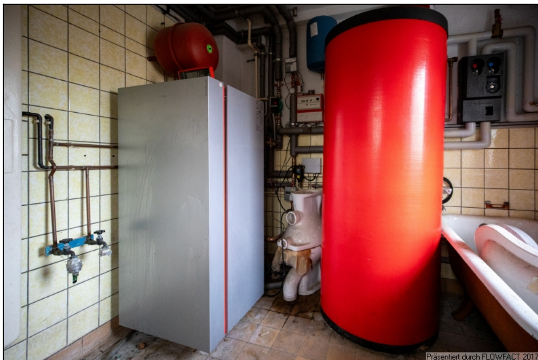
Zentralheizung mit Pufferspeicher
