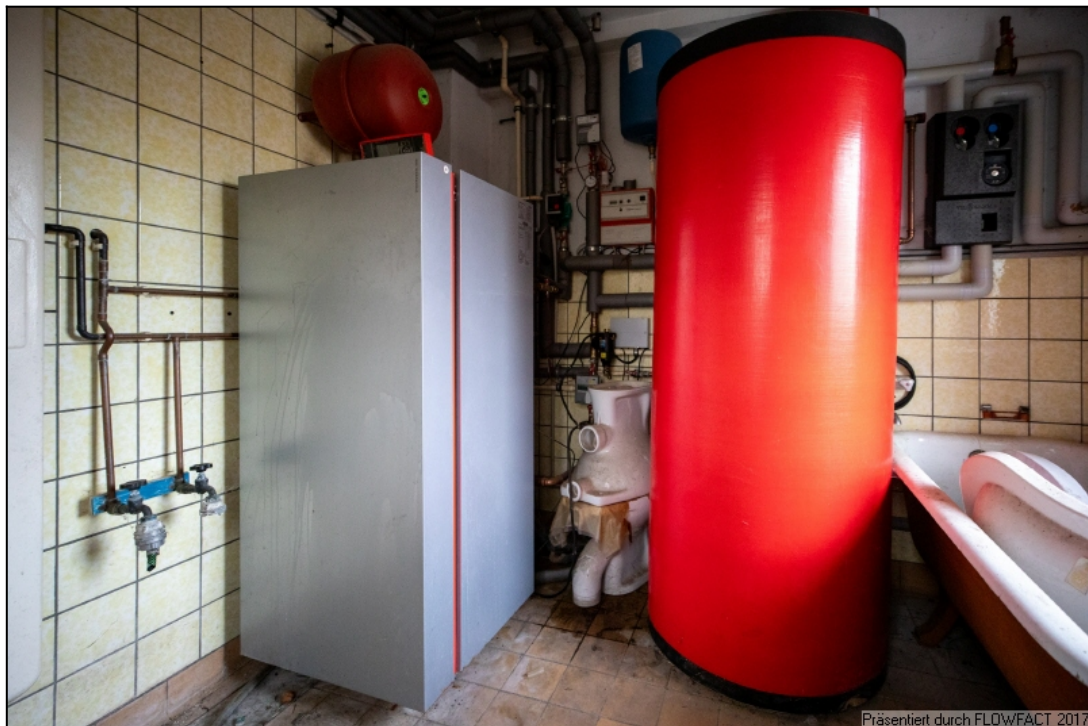
Zentralheizung mit Pufferspeicher
