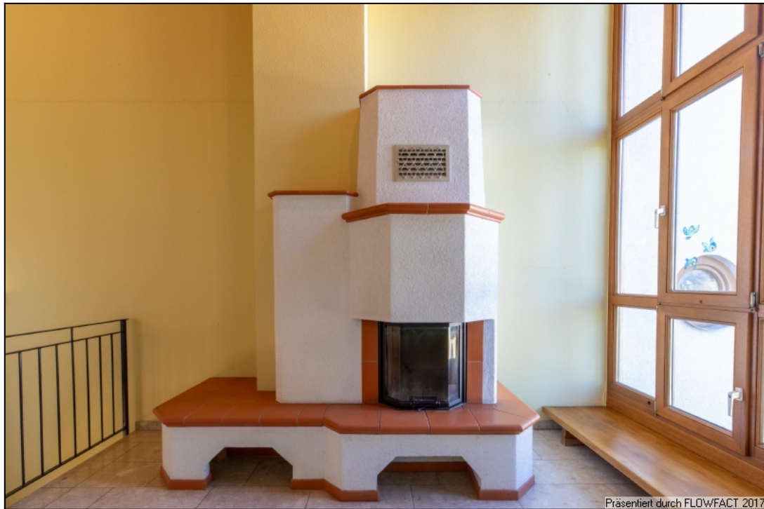
Kaminanlage im Obergeschoss
